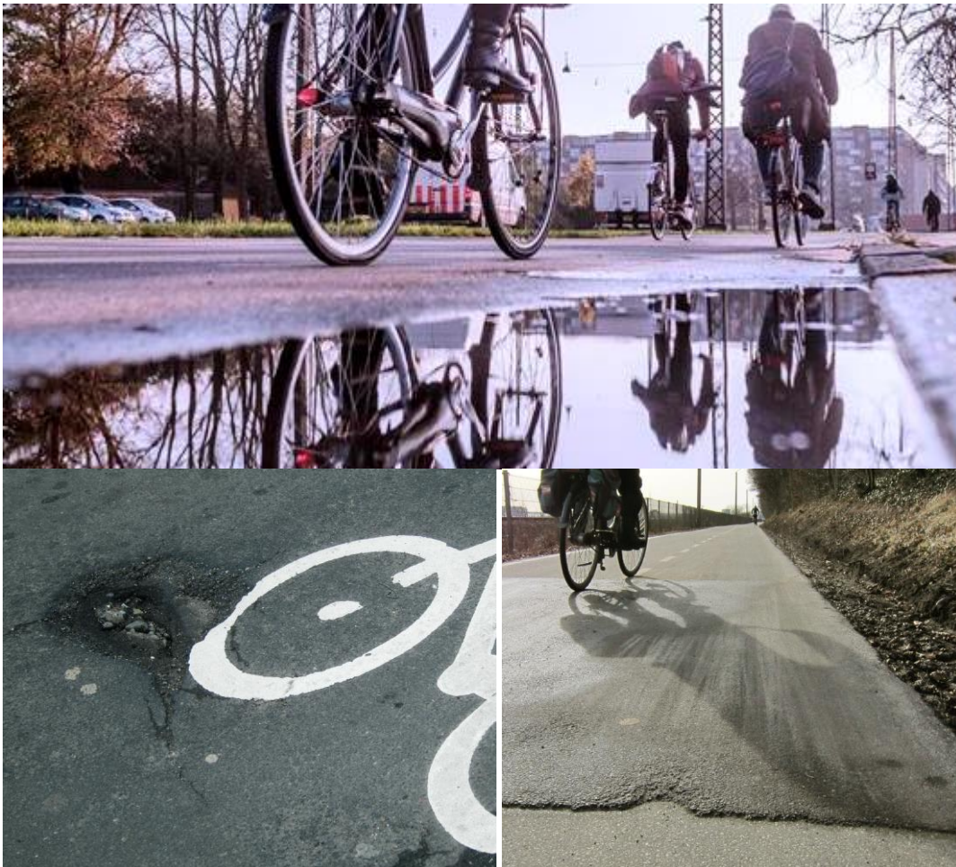
Figur 8.2 Dårlig afvanding, huller i belægningen og dårlig reetablering efter anlægsarbejder er eksempler på forhold, der skal imødegås i drift og vedligehold. Foto: Vejdirektoratet og Håndbog i cykelstiinspektion
