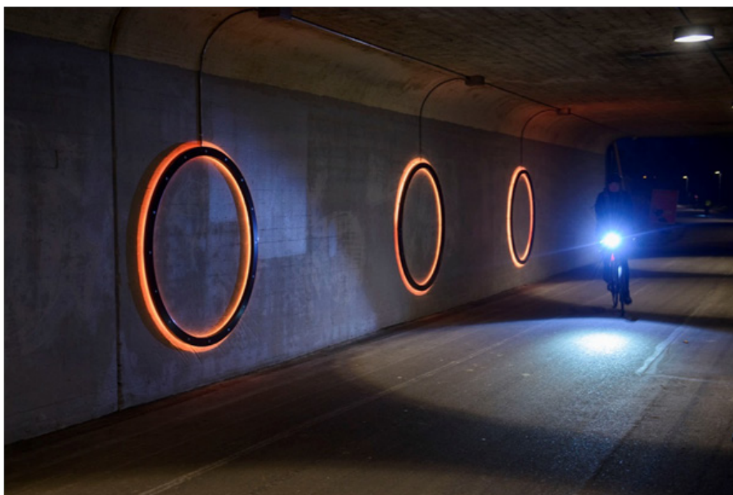
Figur 7.2: På Farumruten er der etableret en intelligent tunnelbelysning, der giver en målrettet funktionsbelysning og samtidig et visuelt løft, og som reagerer på cykler igennem tunnelen, ved at hjulene drejer rundt og skaber tryghed.
